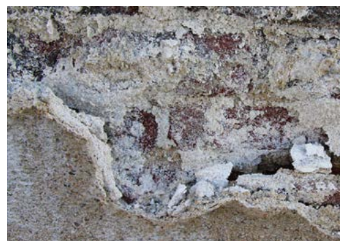
Typische schade veroorzaakt door zoutuitbloei
